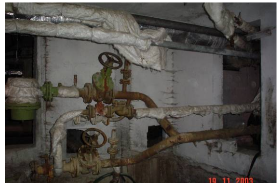
Типичный тепловой пункт в жилых зданиях микрорайона «Солнечный»
