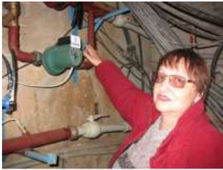
Голова ОСББ «Покоління» демонструє нове обладнання автоматичного регулювання теплоносія
